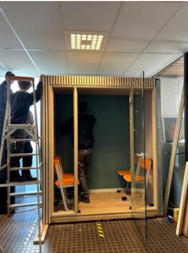
Hier is de glazen deur ondertussen geplaatst en zijn we al bezig met het plaatsen van de akoestische panelen.
